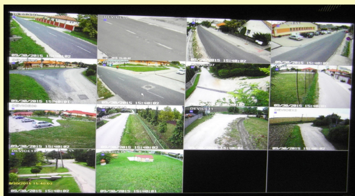
14 kamerás térfelügyelő kamerarendszer kiépítése.
