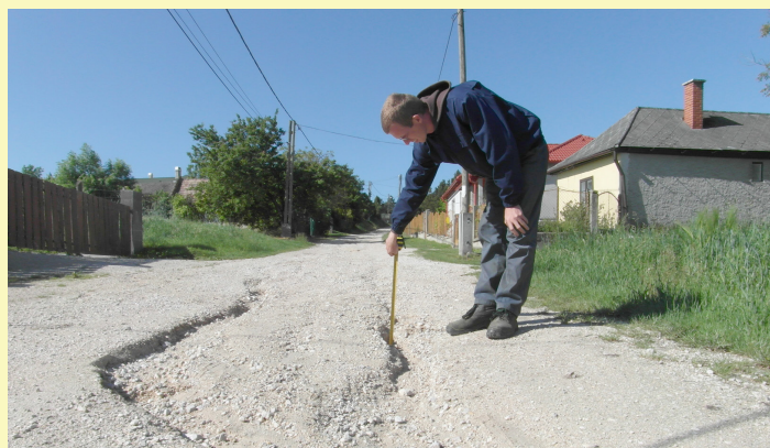
Petőfi utca kimosódott burkolata felhőszakadást követően
